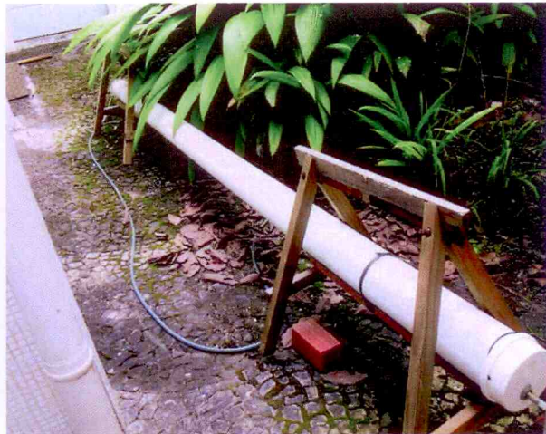
Figura 5- unidade de tratamento tubular de esgoto
