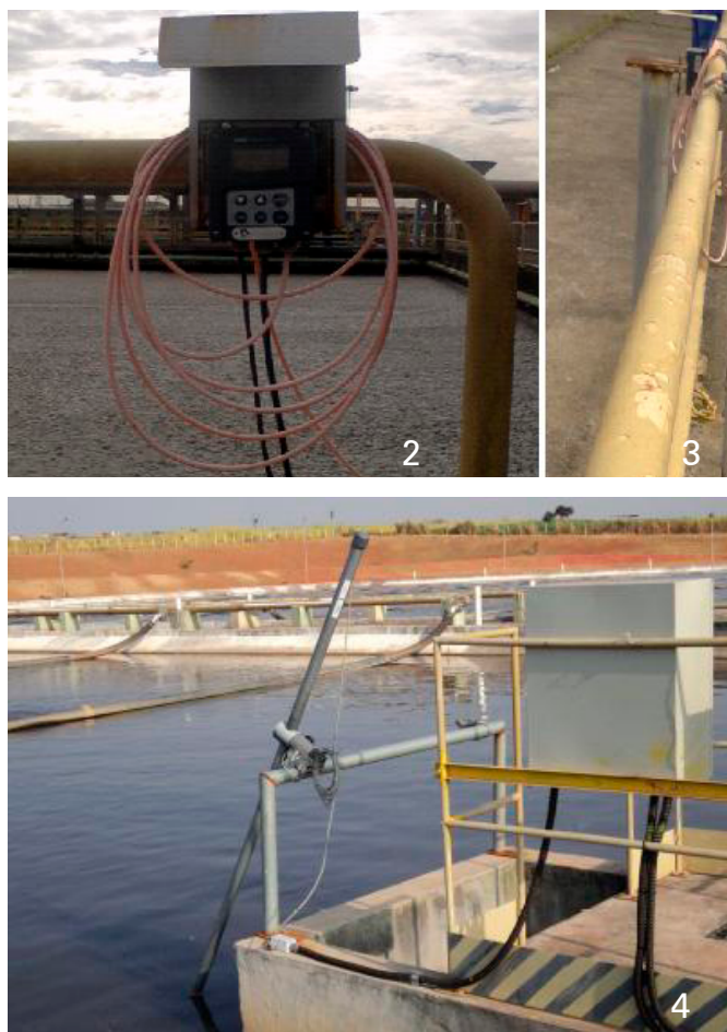
Figuras 2 a 4: (2 e 3) Sensor por membrana instalado na ETE Barueri. (4) Sensor por luminescência instalado na ETE de Paulínia.
