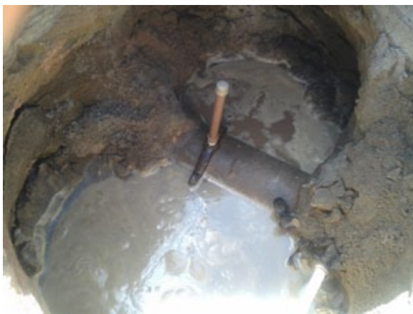
Figura 6 – Ramal clandestino encontrado durante os reparos de vazamentos
