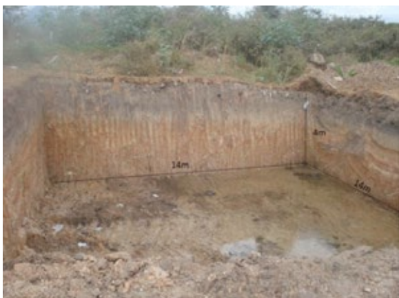
Figura 1 – Escavação executada para a construção da célula experimental na área do ASMOC.
