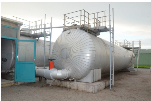
Figura 4: Unidade de Recebimento de Lodo Industrial da ETE Manheim - Alemanha
