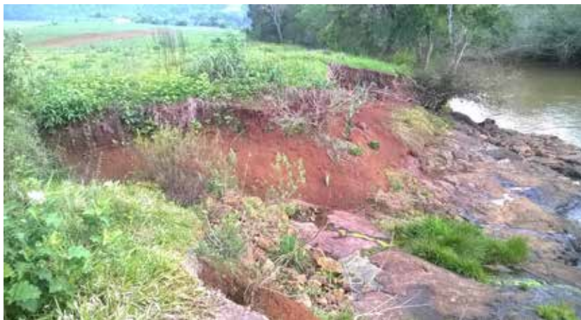
Figura 1: Processo erosivo nas margens da barragem.
