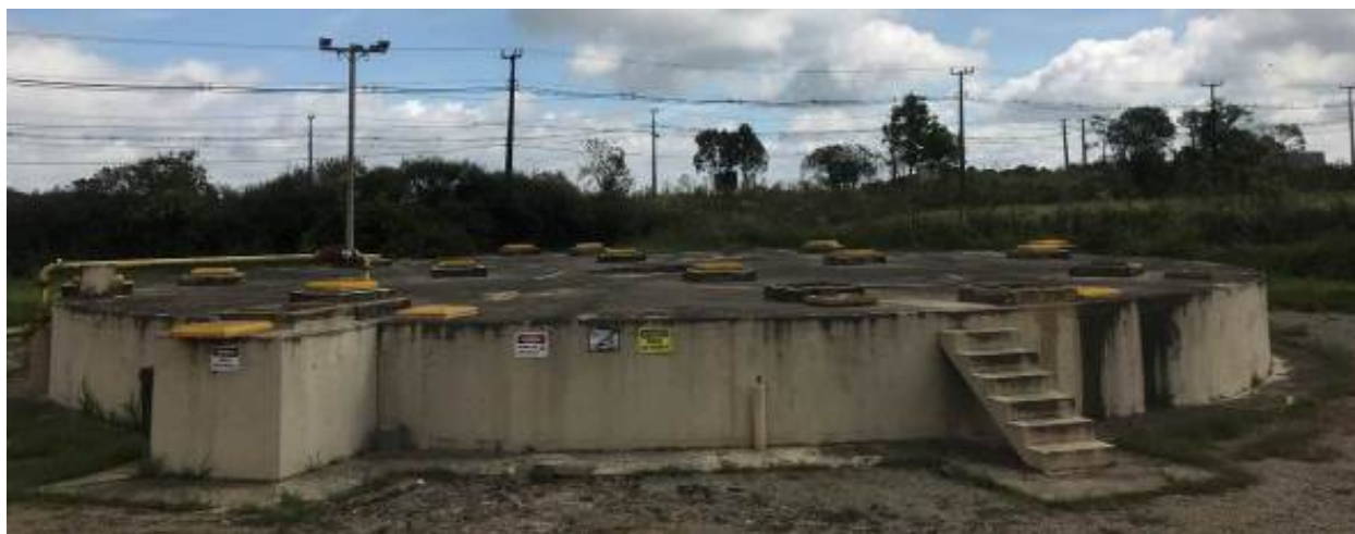
Figura 5 - Vista do reator da ETE H.
