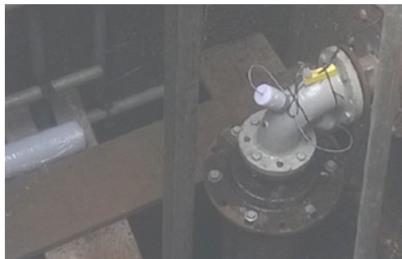
Figura 14 – A foto mostra o sensor já instalado no local.
