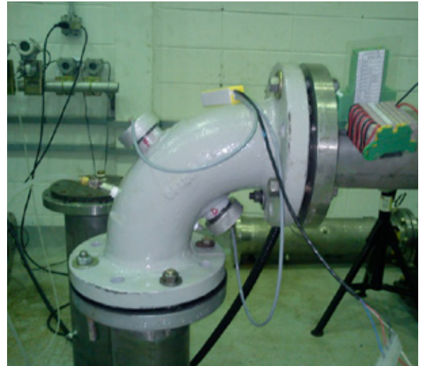
Figura 8 – Vista lateral do transmissor piezorresistivo instalado em laboratório. Observar que não há linha de pressão para transmitir pressão desde a tomada de pressão na tubulação até o sensor de pressão.
