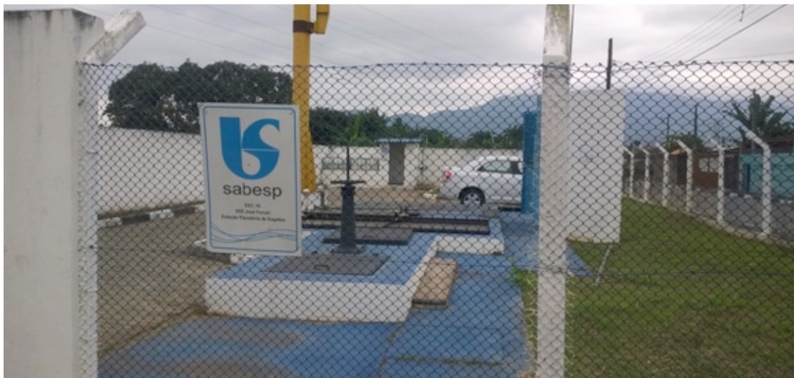
Figura 10 – Entrada da Estação Elevatória EEC 16 – EEE José Ferrari, em Caraguatatuba, onde foram realizados os ensaios em campo.
