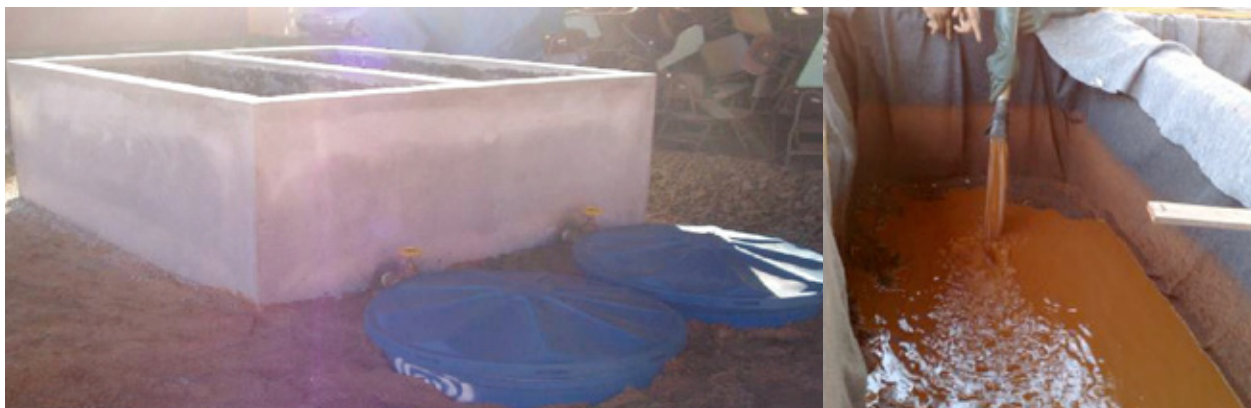
Figura 1 – Leito de drenagem utilizado no desaguamento do lodo de ETA
