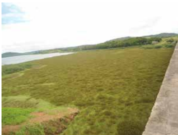
Figura 1: Presença de plantas marginais e flutuantes na Barragem de Tapacurá - São Lourenço da Mata/PE.
