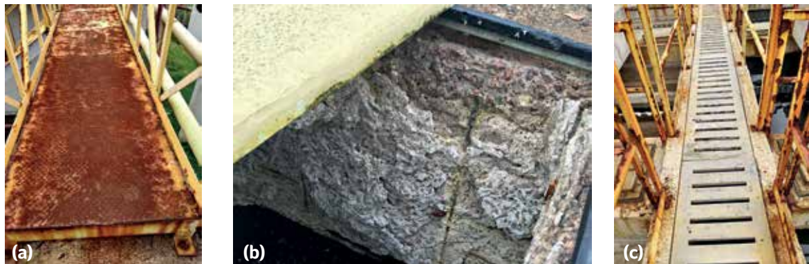
Figura 2 - Fotos de detalhes da corrosão em: a) passarela metálica; b) estrutura de concreto; c) estruturas metálicas de guarda-corpo.
