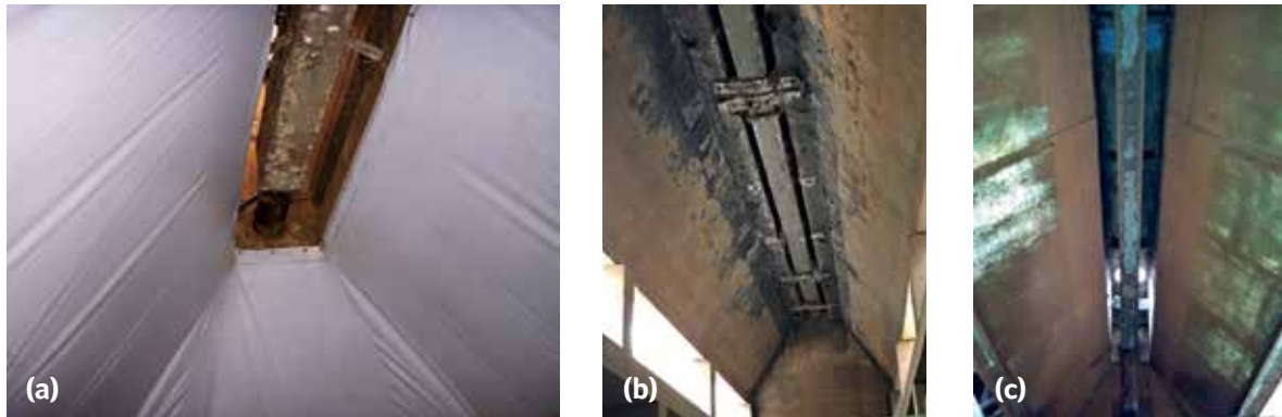
Figura 12 – Separadores trifásicos com canaleta interna de coleta de espuma: a) STF confeccionado em concreto e lona, com canaleta em alumínio; b) STF confeccionado em concreto, com canaleta em PRFV; e c) STF confeccionado em PRFV, com canaleta em PRFV.
