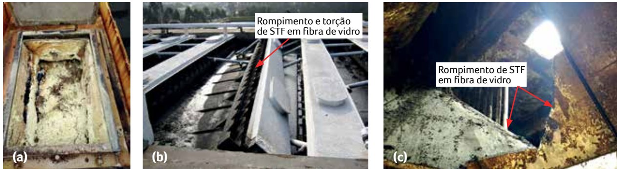
Figura 11 – (a) Escuma solidificada no interior do separador trifásico; (b e c) Rompimento de separador trifásico.
