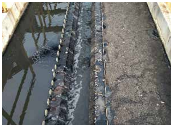
Figura 4 - Acúmulo de espuma em decorrência de vertedores desnivelados.
