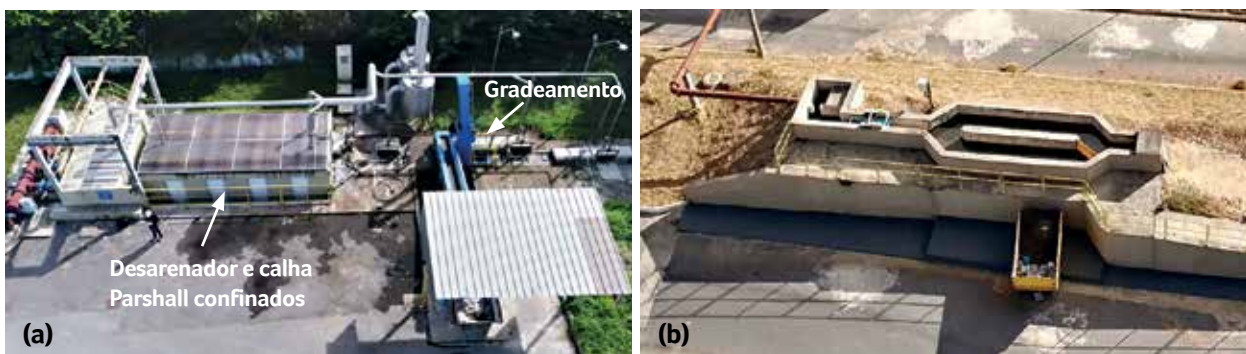
Figura 1 – Unidades do tratamento preliminar: a) Solução enterrada e enclausurada; b) Solução elevada.
