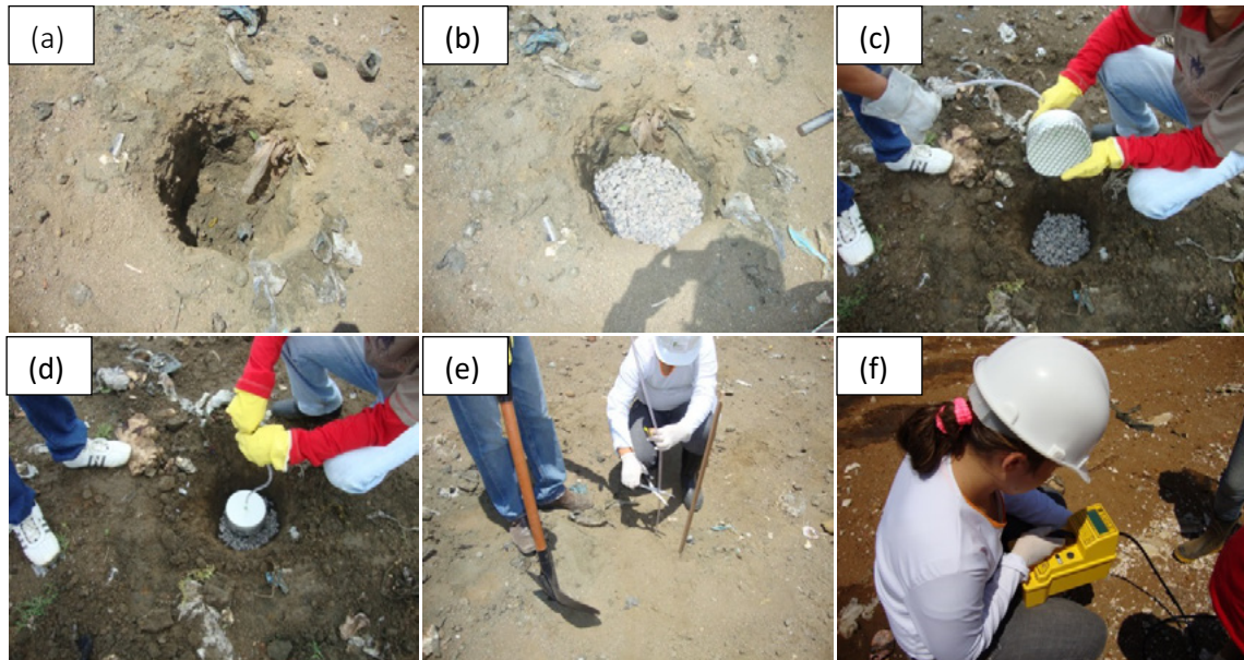
Figura 4 - Etapas de instalação dos dispositivos de leitura. (a) Furo superficial; (b) Preenchimento com brita; (c) (d) Inserção do CAP; (e) Cobertura do dispositivo de leitura; (f) Medição do biogás com o aparelho portátil Fonte: O Autor.
