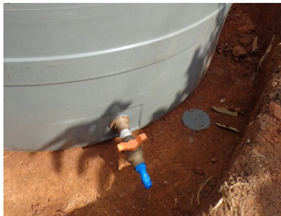
Figura 9 - Tubo para retirada de lodo de tanque séptico.
