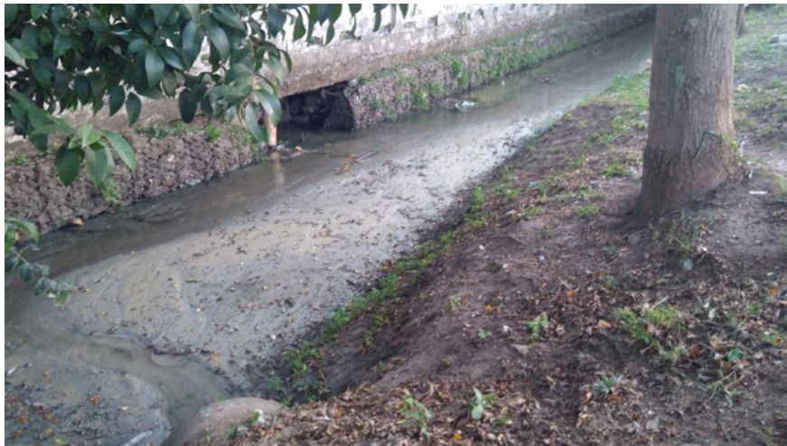
Figura 7 - Assoreamento em trecho do Córrego Tenente Rocha.
