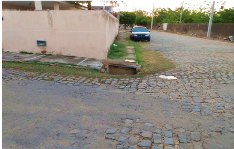
Figura 4 - Caixa de boca de lobo sem tampa.
