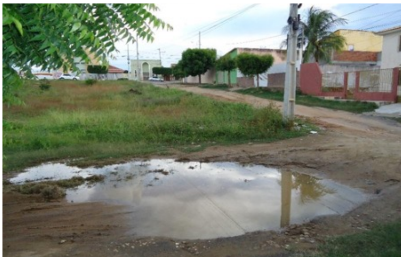
Figura 3 - Alagamento na Rua Protázio de Souza Lima.
