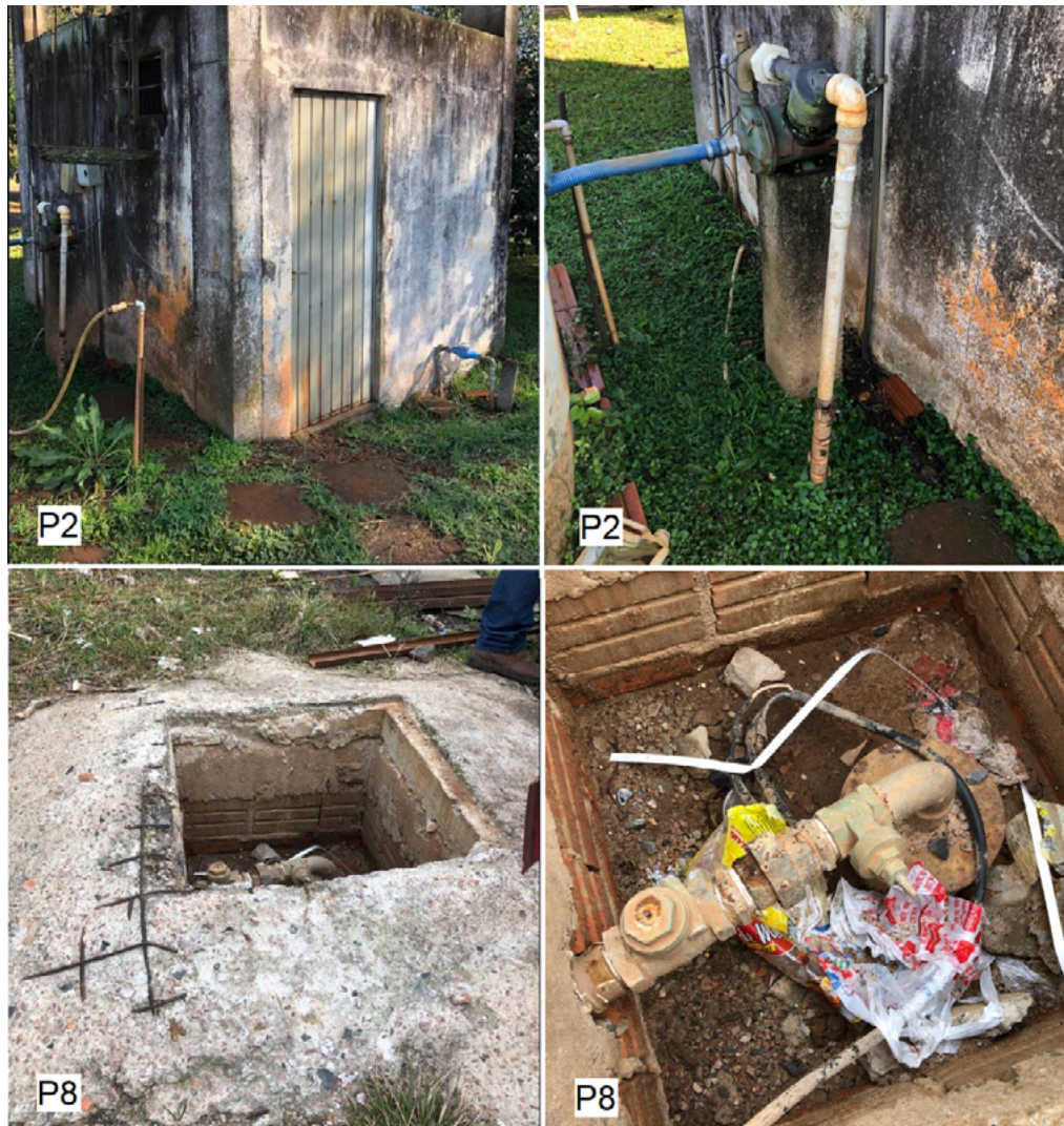
Figura 2 – Caracterização das condições construtivas e de conservação do entorno dos poços enquadrados como risco elevado de vulnerabilidade (P2 e P8).
